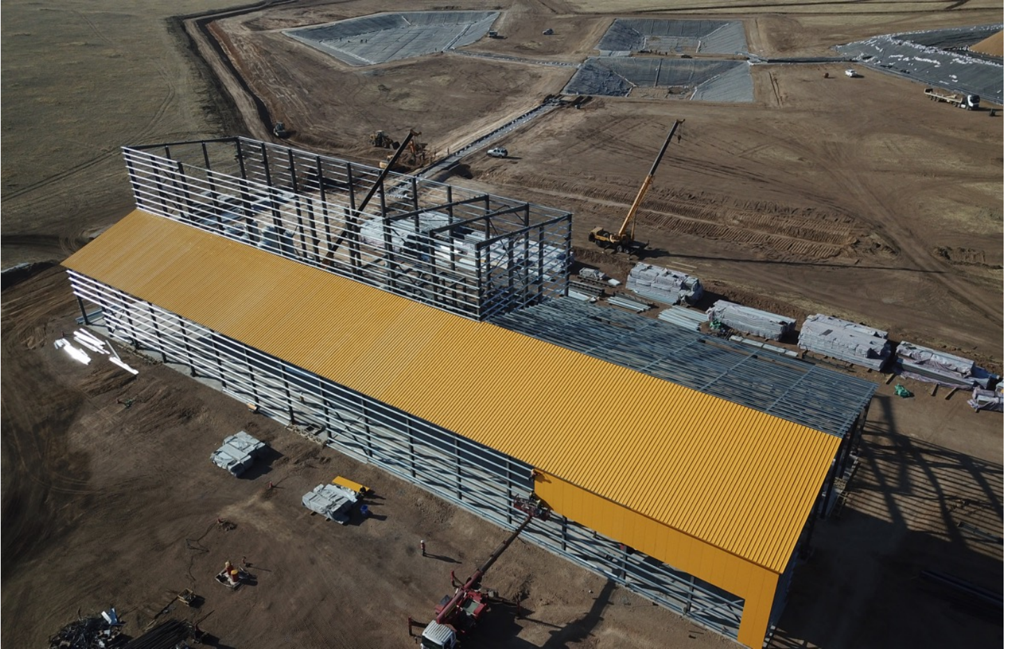
ADR Anlage, Regenwasser, karge und imprägnierte Teiche (Rückseite Mitte), Zelle 1 & 2 (rechts) - 25. April 2019
