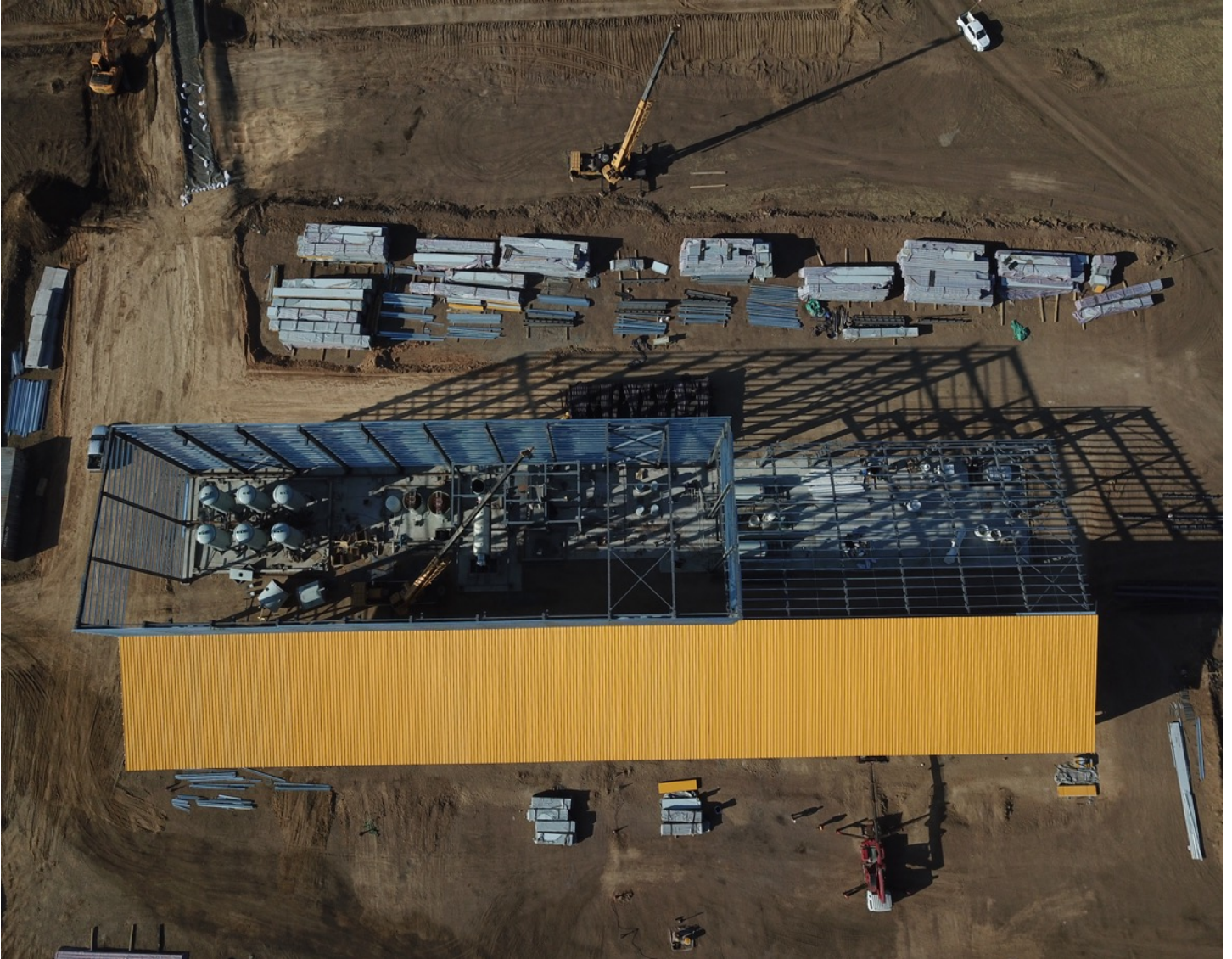
ADR-Anlage mit errichteten und installierten Kohlenstoffsäulen (Hintergrund) - 25. April 2019
