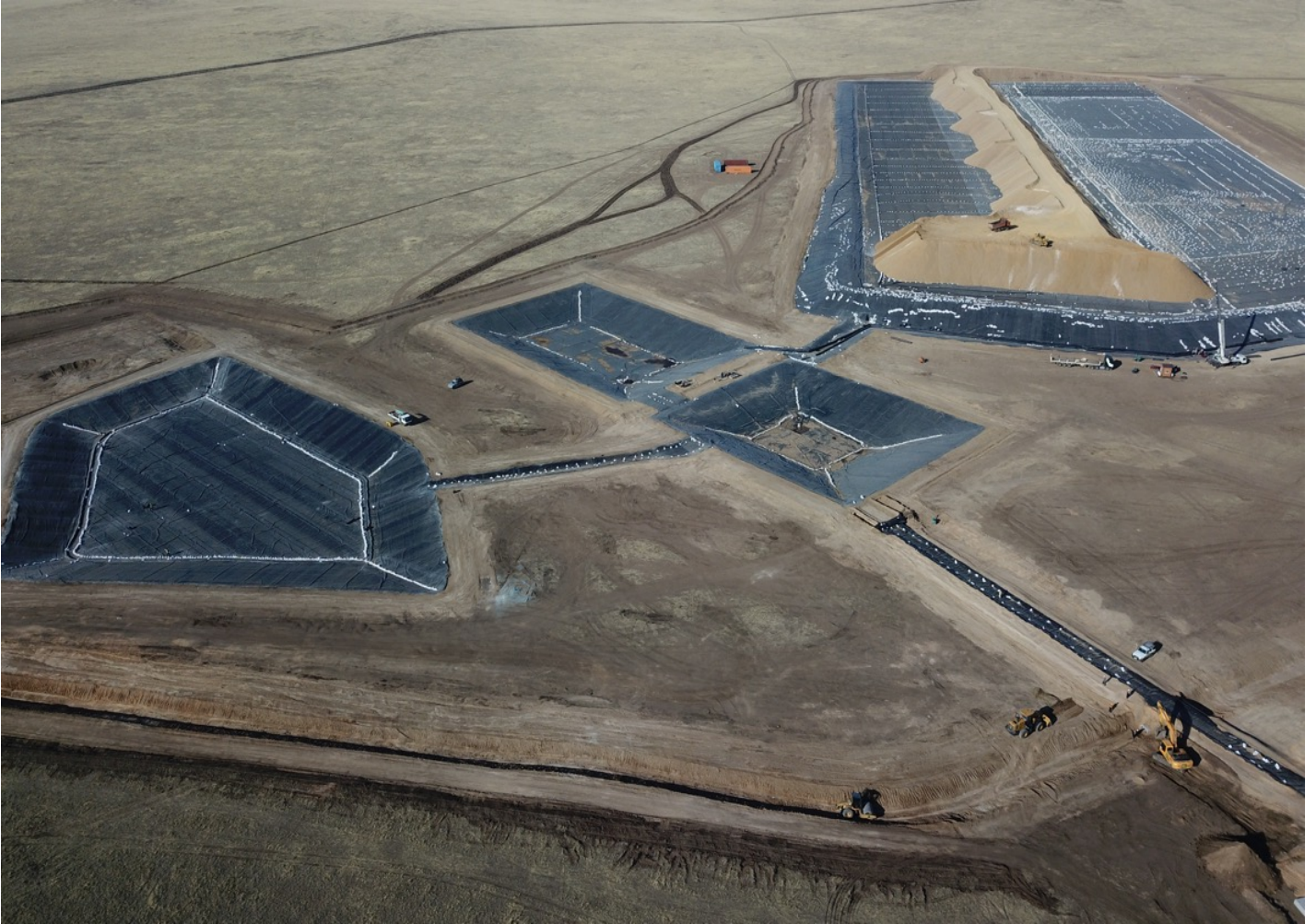
Regenwasserteich (links), karge und imprägnierte Teiche (Mitte), Zelle 1 & 2 (rechts) - 25. April 2019
