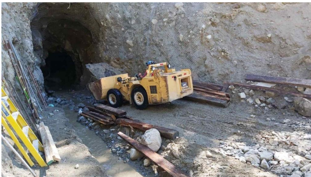
Foto des Scooptram-Laders am 257-Portal bei Kenville in der letzten Phase der Abtragungsarbeiten.
