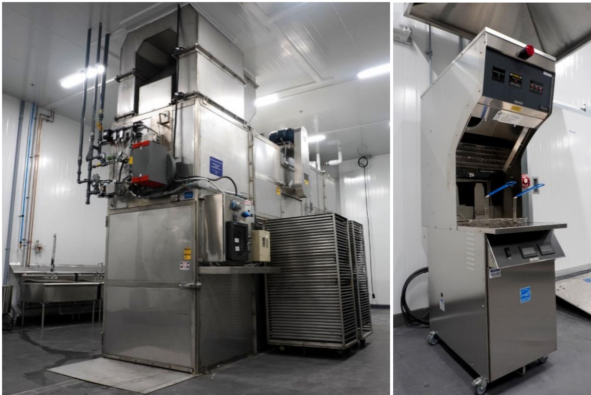
Komplementäre Lebensmittelproduktionsanlagen REVworx™, darunter ein CDS McKenzie Lufttrockner und eine Friteuse
